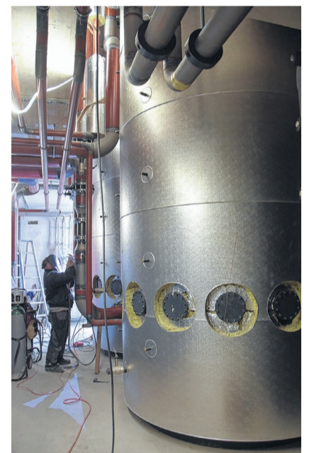
Imposante Technik: Diese beiden Tanks sind zwei Stockwerke hoch.
