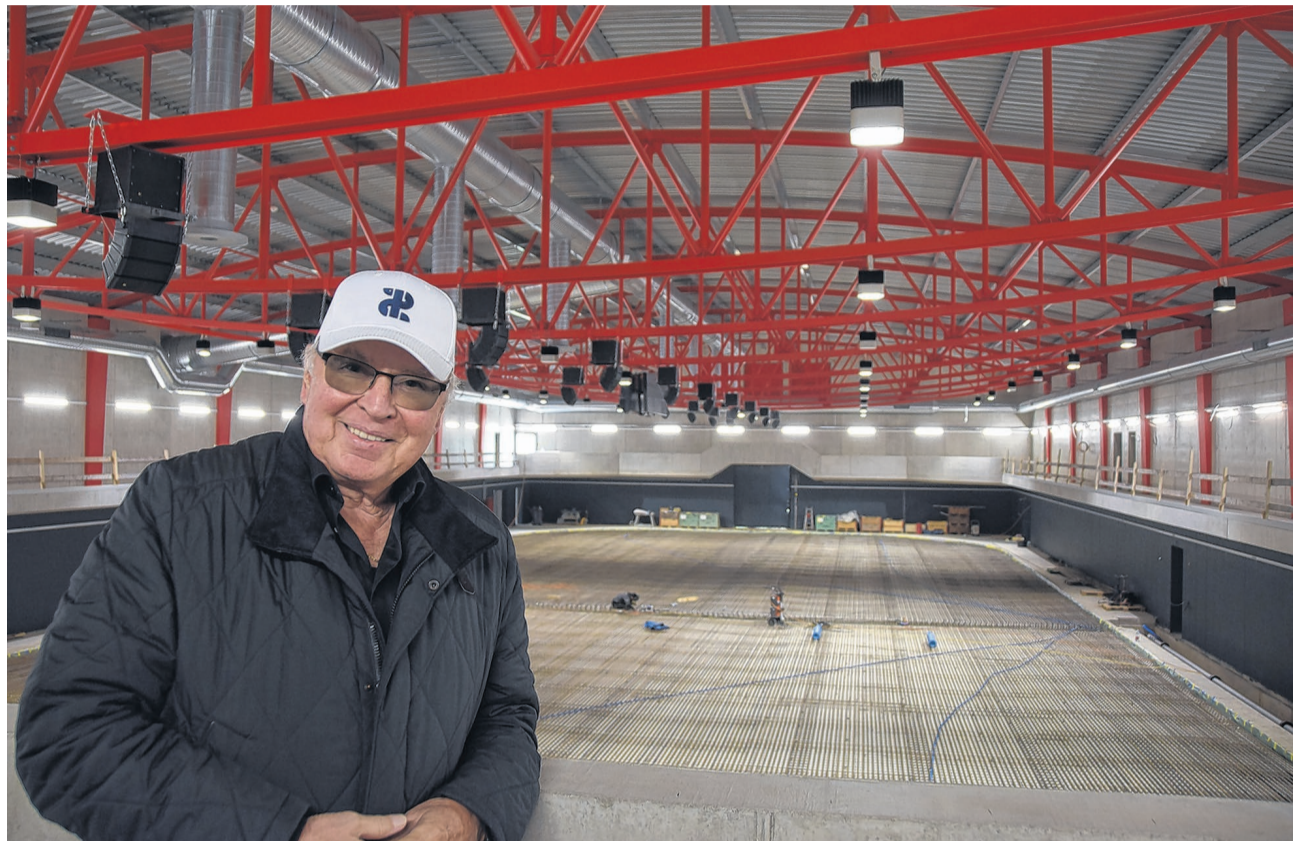
Walter Widler zeigt stolz seine Eishalle: Aktuell noch voll im Bau, wird sie ab Oktober in Betrieb sein.
